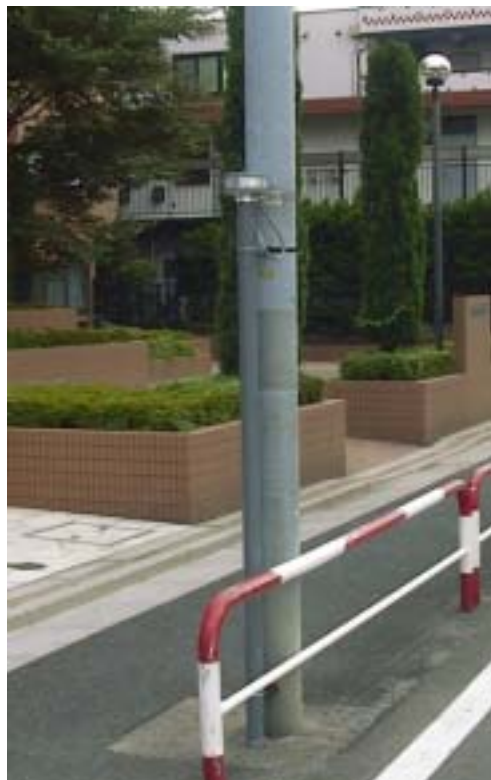
電柱を使う場合電力会社の許可が必要です。
